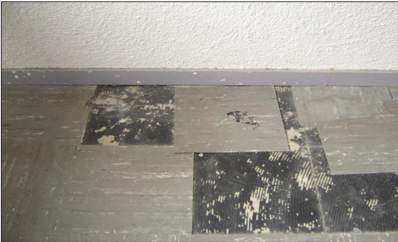
Asbesthaltiger Bodenbelag und Kleber
