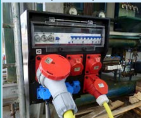
Stromverteiler mit Steckdosen (stationär)
