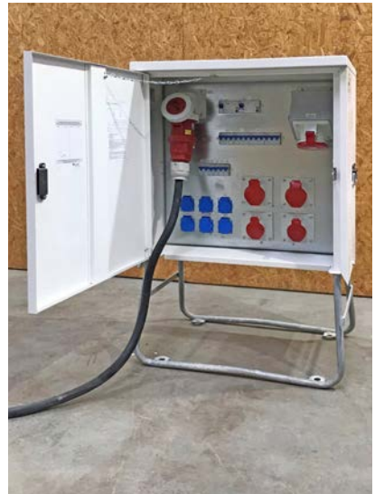
Abb. 10 Baustromverteiler mit Gerätestecker
