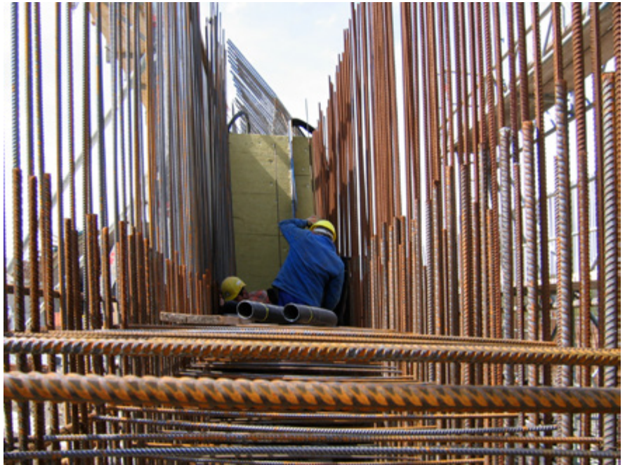
Abb. 19 Beispiel für erhöhte elektrische Gefährdung
