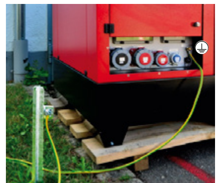
Abb. 15 Stromerzeuger mit Erdungsanschluss und Erdspeiß
