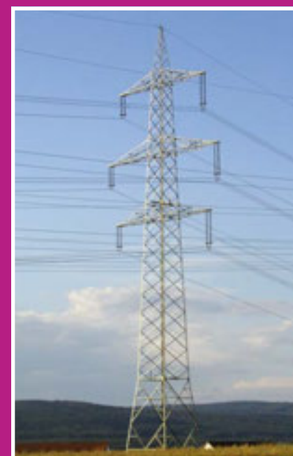
Masthöhe ca. 35 – 75 m links 220 kV, rechts 380 kV
