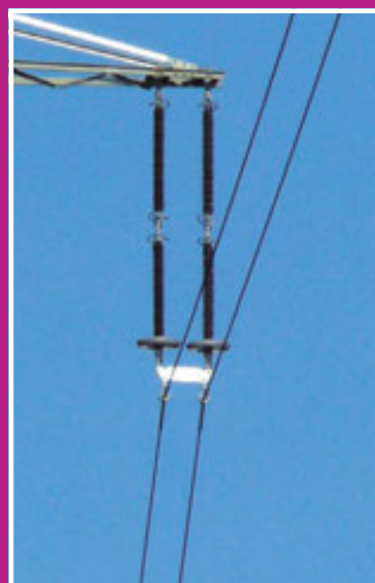
Länge der Isolatoren ca. 2,30 m, 220 kV
