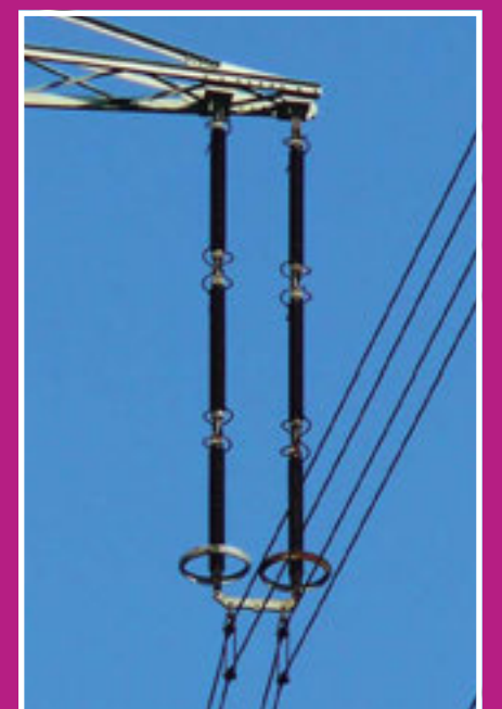
Länge der Isolatoren ca. 3,50 m, 380 kV
