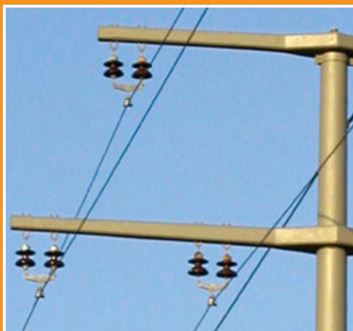
Länge der Isolatoren ca. 0,25 m
