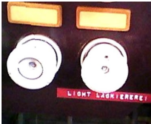
Abb. 24.1 Verteilung mit Diazed-Sicherungen
