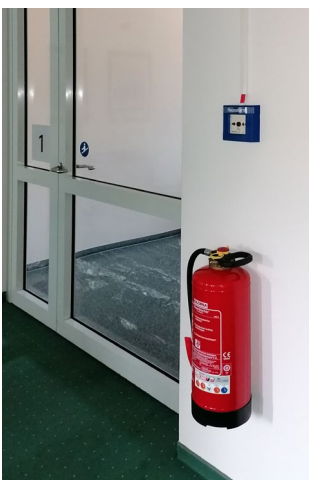
Abb. 49 Gut sichtbarer und leicht erreichbarer Feuerlöscher
