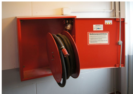
Abb. 67 Wandhydrant als Selbsthilfeeinrichtung
