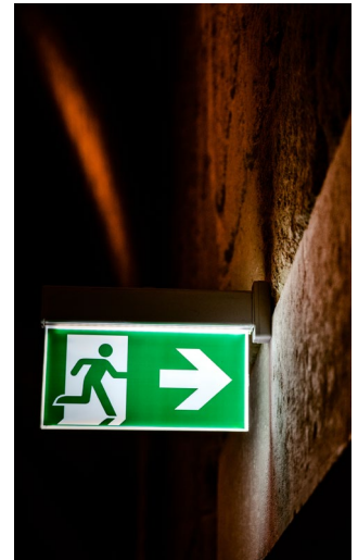
Abb. 19 Notlichtsystem als Sicherheits- und Rettungszeichenleuchten
