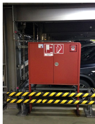
Abb. 50 Vor Beschädigungen und Witterungseinflüssen geschützte Feuerlöscheinrichtungen
