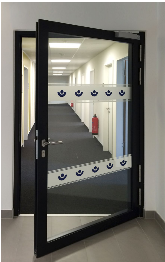
Abb. 9 Brandschutztür mit Verglasung
