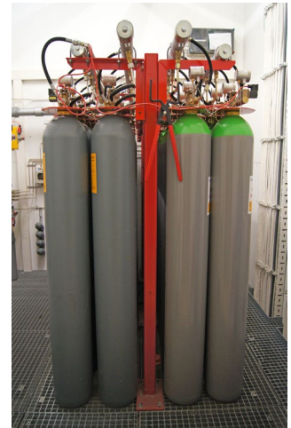
Abb. 62 Flaschenstation einer Gaslöschanlage
