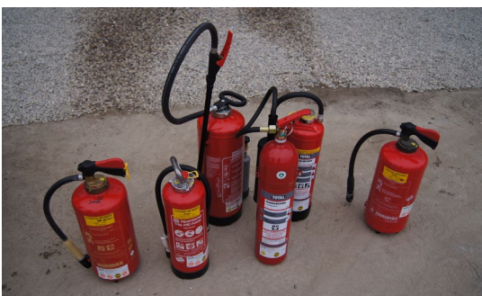
Abb. 44 Diverse tragbare Feuerlöscher
