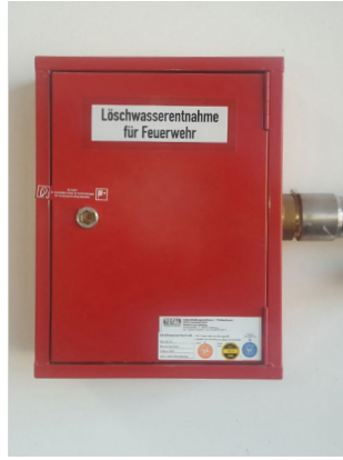
Abb. 64 Entnahmestelle einer trockenen Löschwasserleitung
