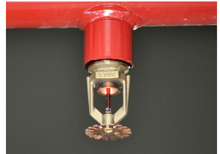
Abb. 58 Installierter Sprinkler im Rohrnetz
