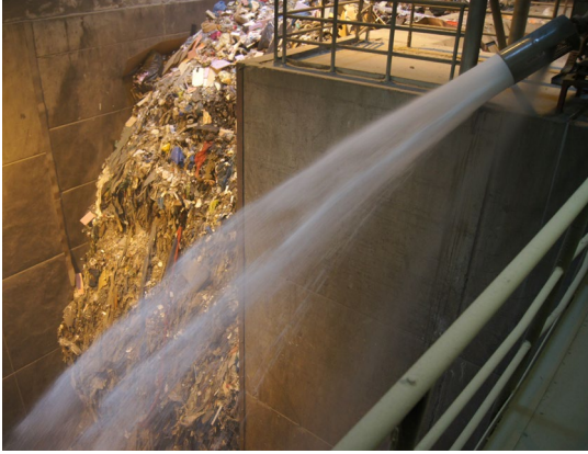
Abb. 63 Stationäre Schaumlöschanlage in einem Abfallbunker
