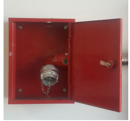
Abb. 65 Entnahmestelle einer trockenen Löschwasserleitung
