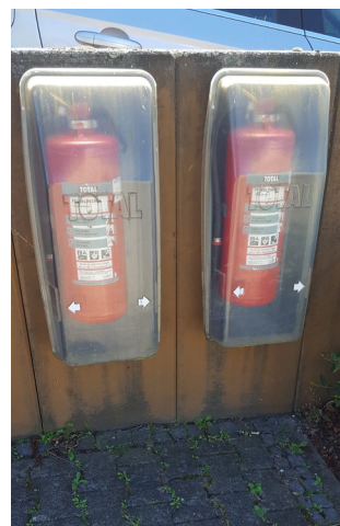
Abb. 51 Vor Witterungseinflüssen geschützte Feuerlöscher
