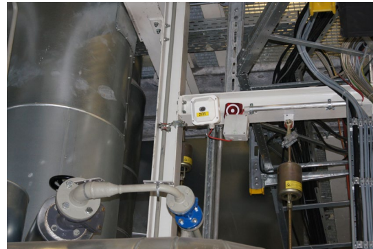
Abb. 34 Flammenmelder an einer Industrieanlage
