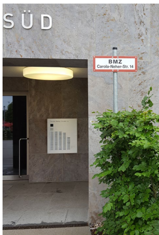
Abb. 32 Beschilderung einer Brandmeldeanlage vor einem Gebäude
