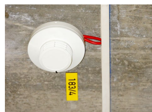
Abb. 33 Rauchmelder an einer Raumdecke
