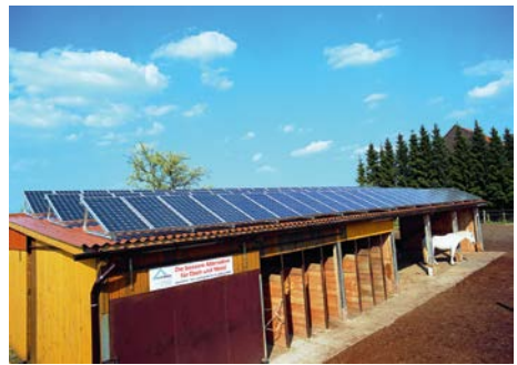
Abb. 8 PV-Anlage auf landwirtschaftlich genutztem Gebäude.
