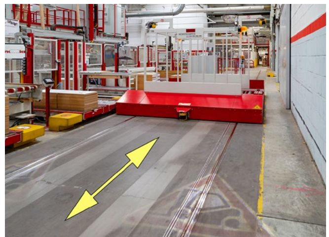
Abb. 85 Quer-verschiebewagen mit Laserscanner und Projektion der Piktogramme auf Boden „Achtung Staplerverkehr“
