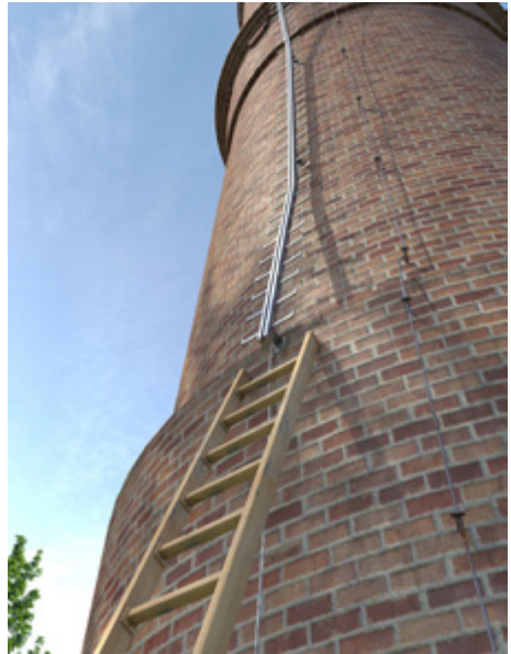
Abb. 13 Unsichere Zugangssituation bei Steigleitern an Schornsteinen
