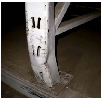
Abb. 12 Gerissene Schweißnaht an der Fußplatte der Stütze
