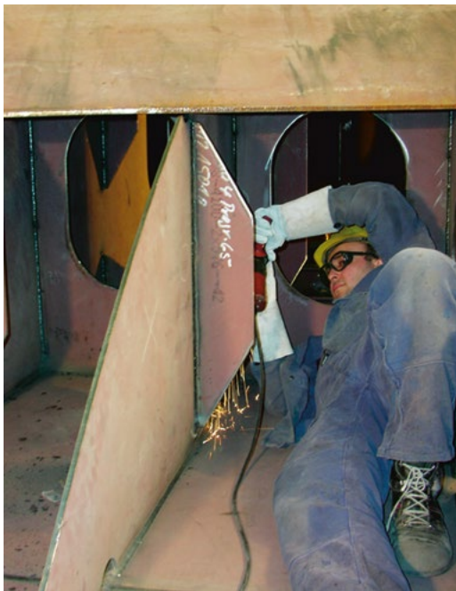
Abb. 9-1 Enger Raum mit erhöhter elektrischer Gefährdung
