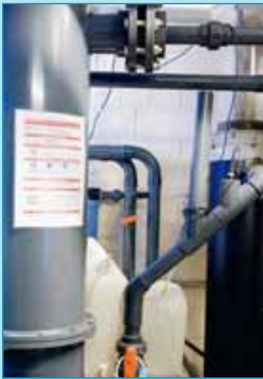
Wasseraufbereitungsanlage mit Betriebsanweisung
