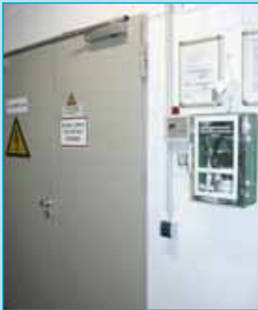
Zugang zu einer Ozonanlage mit optischer Warneinrichtung. Falls Ozon austritt, darf der Raum nur mit der persönlich zugeordneten Atemschutzmaske betreten werden.
