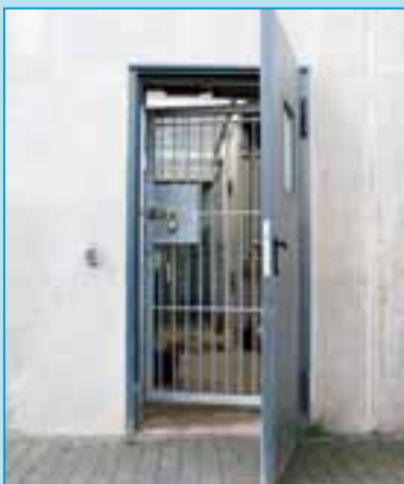
Durch Gittertür (äußere Schleusentür) gut einsehbare Schleuse (Bediengang) – zweite Tür aus klimatischen Gründen
