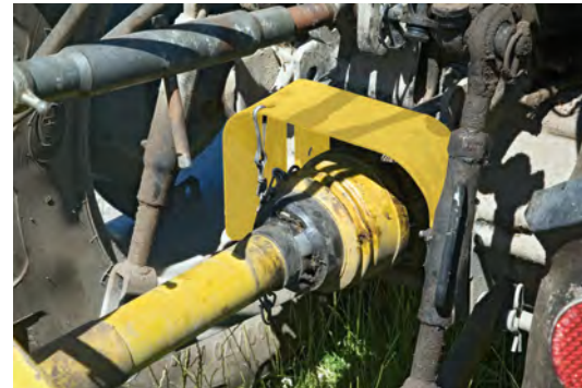
Abb. 41 Gelenkwellen sind bis über die Kreuzgelenke zu verkleiden. Der Schutz ist gegen Mitdrehen zu sichern.
