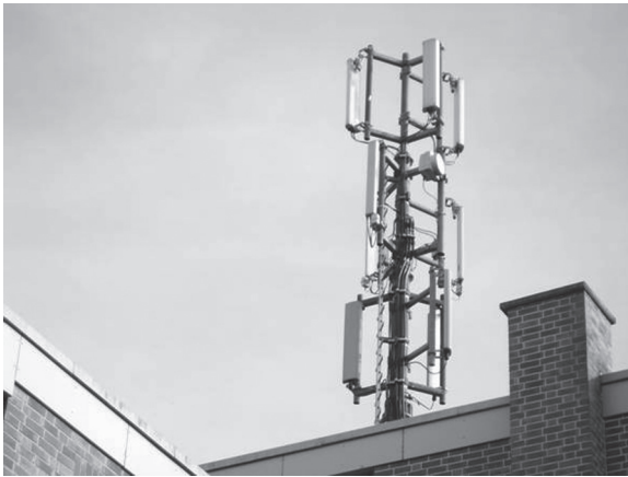
Abbildung 18: Sendefunkanlagen für den Mobilfunk
