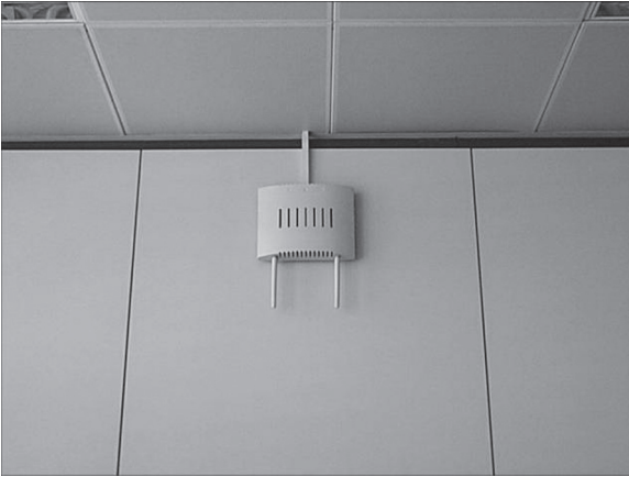
Abbildung 19: Access Point für DECT-Anlagen
